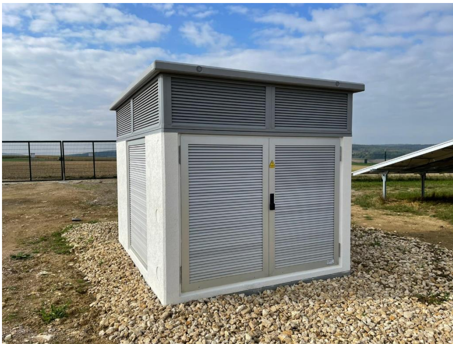
Abb. 6: Beispiel einer Trafostation (Foto: Fa. Sandmeyer GmbH, Cadenberge)
